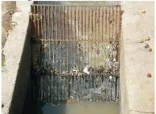
Figura 217 - Grade da EEE Geisel
