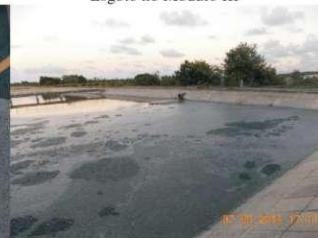
Figura 197 - Tubulação Distribuidora de Esgoto no Módulo III
