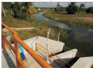
Figura 87 - Captação à fio d'água no rio Abiaí/Papocas
