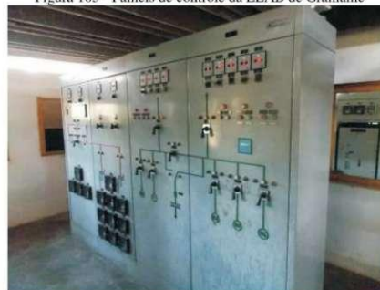
Figura 105 - Painéis de controle da EEAB de Gramame
