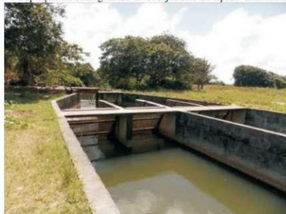
Figura 101 - Captação na barragem de nível a jusante do açude Gramame/Mamuaba
