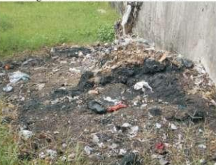
Figura 218 - Acúmulo de resíduos
