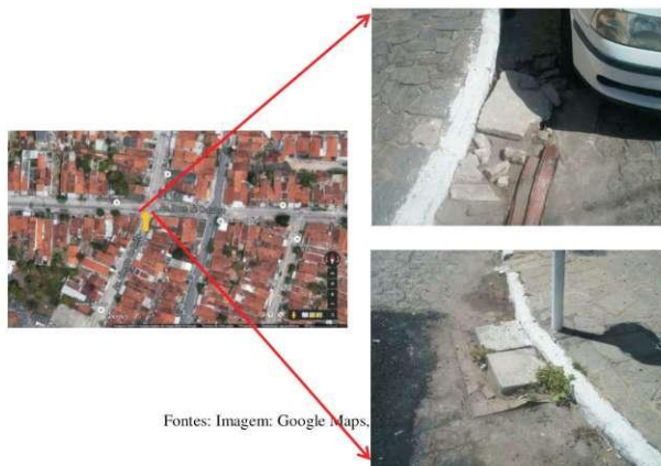
Figura 275 - Problemas de alagamentos no cruzamento da Av. Doze de Outubro com a Av. Alberto de Brito, Jaguaribe, João Pessoa, PB.
