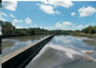
Figura 172 - Deposição de areia na entrada dos Tanques 1 e 2.
