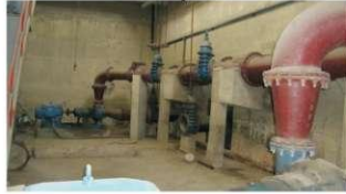
Figura 220 - Bombas centrífugas da EEE Ilha do Bispo IV
