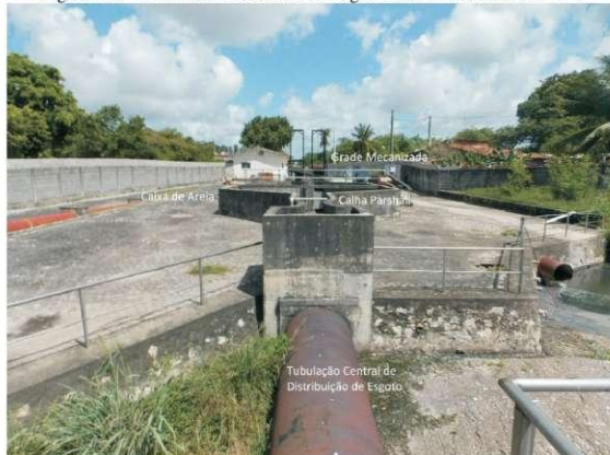
Figura 180 - Tratamento Preliminar da Lagoa Anaeróbia da Pedreira Nº 7
