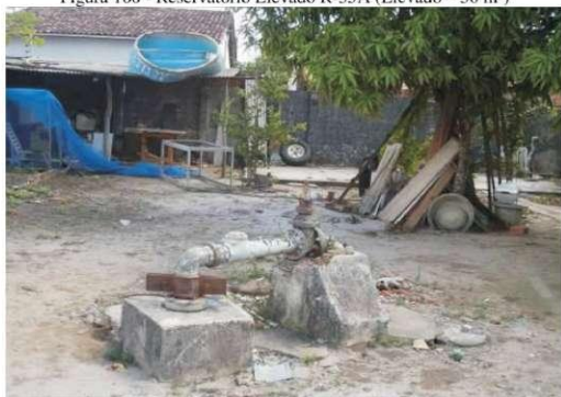
Figura 160 - Reservatório Elevado R-35A (Elevado – 50 m³)
