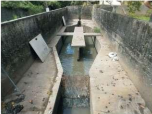
Figura 216 - Grade e Caixa de areia da EEE Geisel
