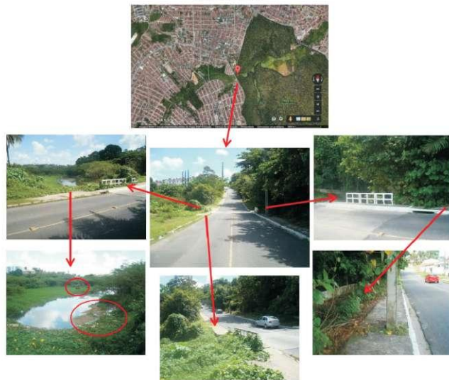
Figura 282 - Ponto de inundação na R. Antônio Silva Melo (ponte sobre o rio Jaguaribe), Jaguaribe/Rangel, João Pessoa, PB. Animal e resíduos sólidos em destaque no leito do rio
