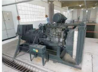
Figura 222 - Gerador a diesel da EEE Ilha do Bispo IV
