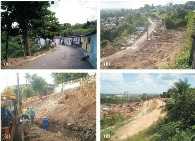
Figura 284 - Trabalhos realizados pela PMJP para “erradicar” o problema de movimentação de massa na Comunidade Saturnino de Brito.
