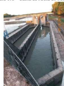
Figura 193 - Caixa de Areia do Módulo II
