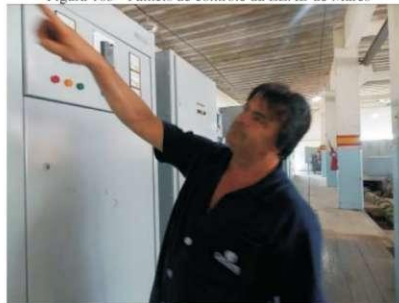
Figura 103 - Painéis de controle da EEAB de Marés
