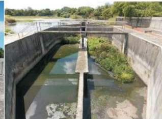
Figura 182 - Caixa de Areia do Tratamento Preliminar da Lagoa Anaeróbia da Pedreira Nº 7
