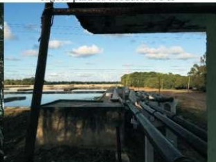
Figura 189 - Tubulações de distribuição de esgoto para os Módulos I e II
