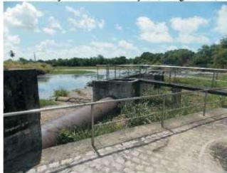
Figura 183 - Assoreamento nos arredores das tubulações de distribuição (Imagem 01)
