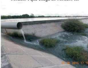
Figura 194 - Tubulação extravasora do Módulo I que chega ao Módulo III
