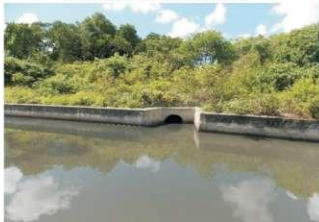
Figura 175 - Entrada do Efluente da Lagoa Anaeróbia da Pedreira no 7
