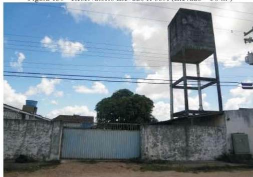
Figura 159 - Reservatório Elevado R-35A (Elevado – 50 m³)
