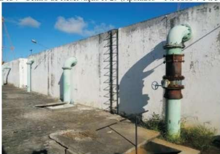
Figura 154 - Centro de Reservação R-29 (Apoiados – 1 x 1000 + 1 x 500 m³)
