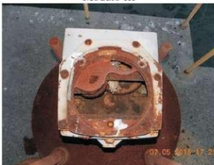
Figura 196 - Carcaça dos aeradores do Módulo III
