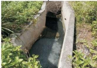
Figura 177 - Caixa de passagem após a saída dos Tanques "S"
