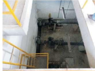
Figura 206 - Bombas centrífugas instaladas na EEE Valentina II
