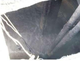
Figura 212 - Poço de Sucção da EEE-46
