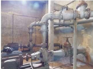
Figura 215 - Bombas centrífugas da EEE Geisel
