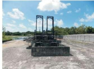
Figura 181 - Grade Mecanizada do Tratamento Preliminar da Lagoa Anaeróbia da Pedreira Nº 7
