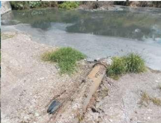
Figura 184 - Assoreamento nos arredores das tubulações de distribuição (Imagem 02)
