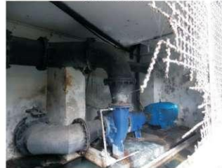
Figura 203 - Bomba centrífuga instalada na EEE Usina 1.
