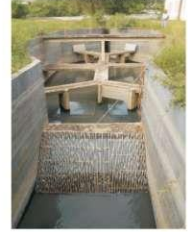
Figura 221 - Grade e Caixa de areia da EEE Ilha do Bispo IV
