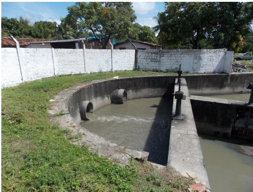
Foto 10 – ETE sem funcionamento no Complexo Linha Férrea
