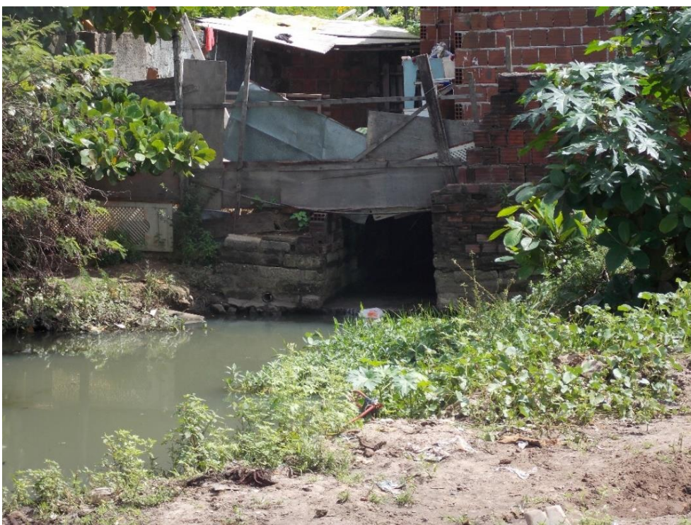
Foto 18 – Vista de trecho do rio Jaguaribe, na altura da rua Agostinho Figueiredo. No centro da foto, identifica-se uma galeria que recebe águas pluviais e esgoto in natura , proveniente de residências situadas em seu entorno
